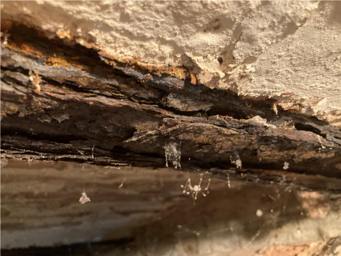
Fotos: Niklas Ohm - Rissbildungen und Rost - dokumentiert 12/2022
